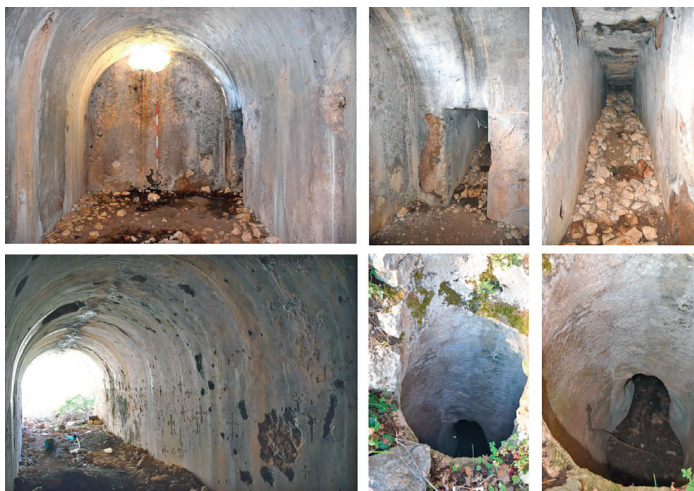
Interno della cisterna con canale di adduzione e pozzo (foto ©Maurizio Zambardi).
