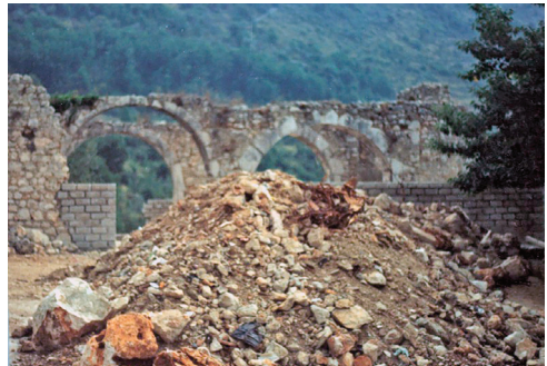
Foto 3 e 4: Villa Santa Lucia. Macerie. Entrambe le foto dovrebbero riferirsi alla chiesa di San Martino ubicata sull'omonimo colle.
